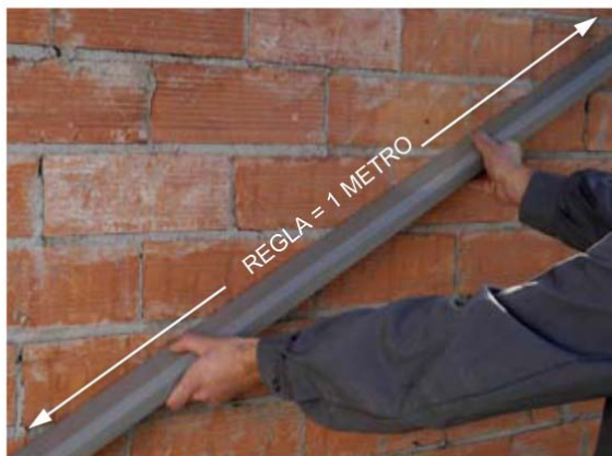
SOPORTE NO REVESTIDO < 5 mm
